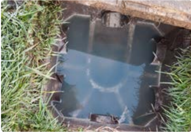
Regard saturé en eau (possible dysfonctionnement par manque d'entretien)
