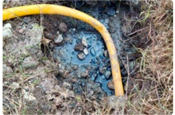
Regard corrodé et perforé (mauvaise ventilation, et manque d'entretien)
