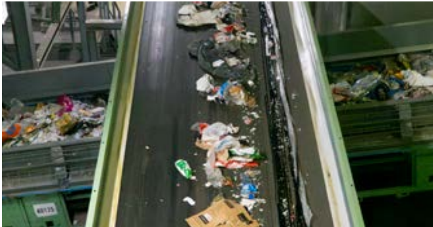
— Une ligne a l'arrêt au Centre de tri du SMDO. Des bandes magnétiques enchevêtrées dans le tapis. —
